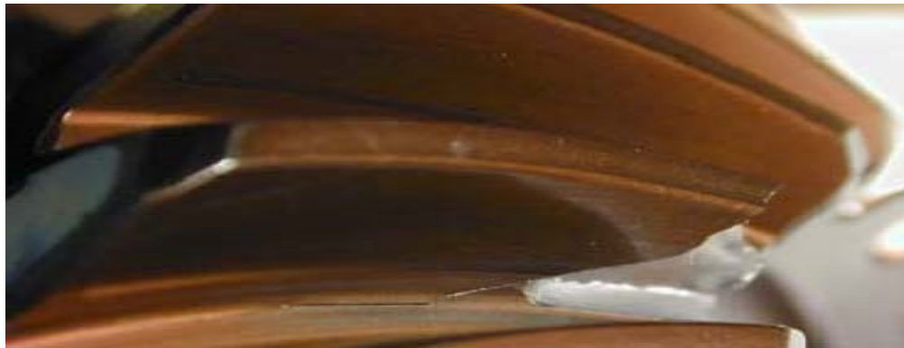
Figure I.8- Défauts de fracture.
