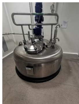
Figure : Cuve de stockage 6000 litres
