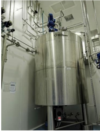
Figure : Cuve de préparation 6000 litres
