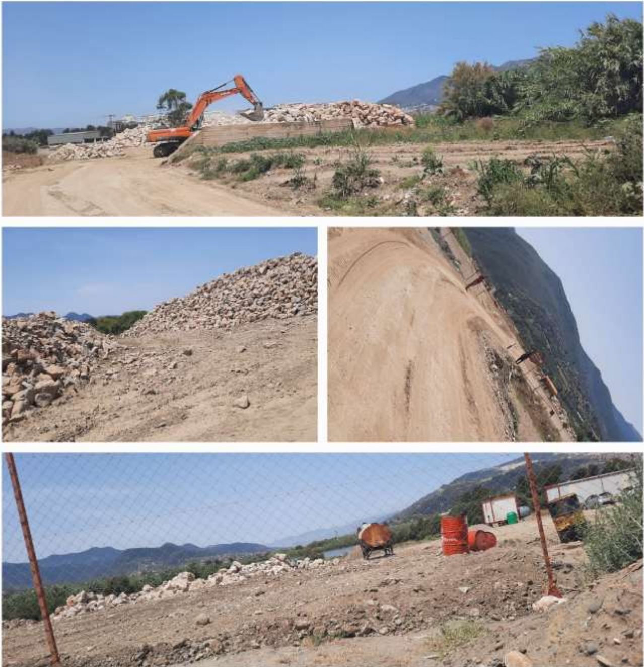
Figure 24 : Exemples de dérangement au niveau du marais de Tamelaht (23 mai 2022)
