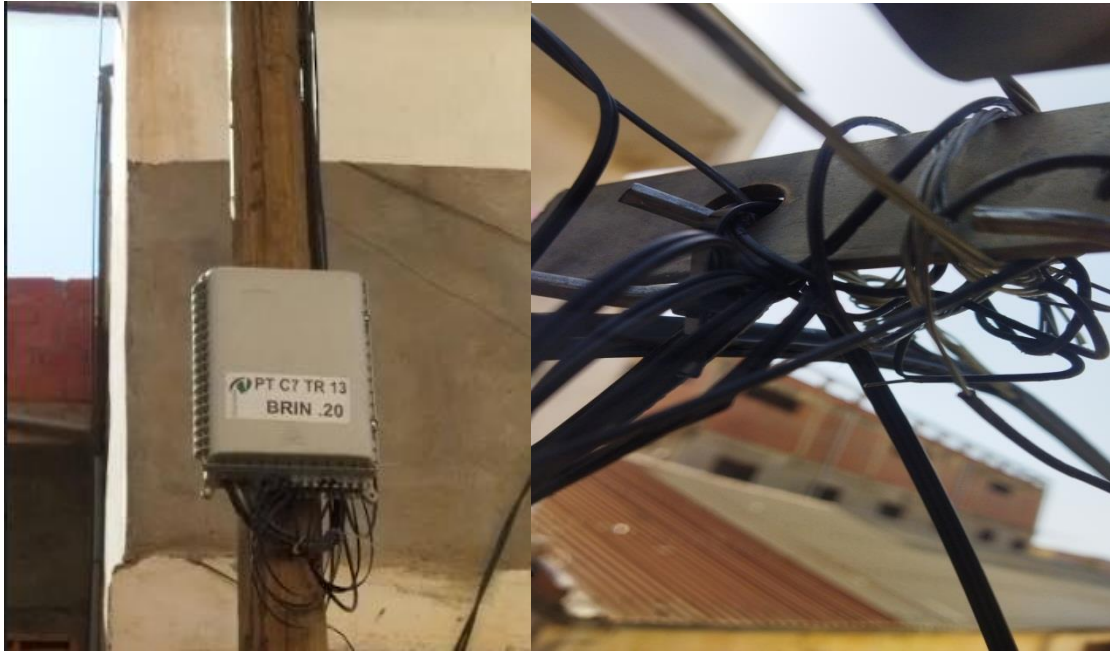
Figure 2-12: Représentation des câbles à fibre optique autoporteurs fixés sur des poteau en bois et sur le support
