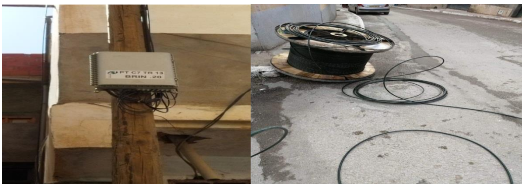
Figure 2-22 Représentation d'un PBO fixé sur pylône et le câble qu'on a utilisé
