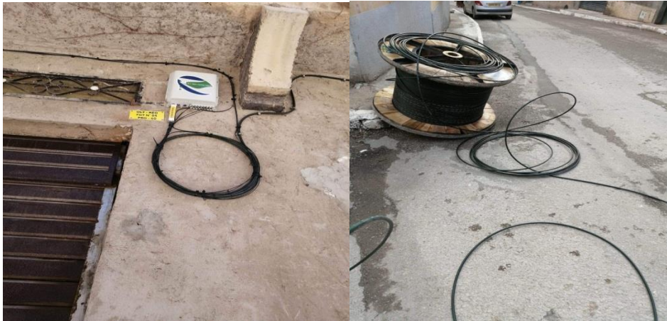
Figure 2-21: Représentation d'un PBO fixé sur façade (mur) et le câble qu'on a utilisé
