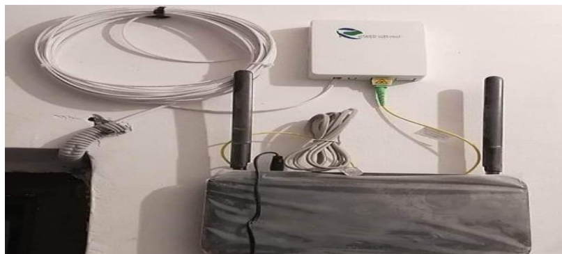
Figure 2-15: Représentation des câbles à fibre optique autoporteurs fixés sur le mur à l'intérieur de la maison
