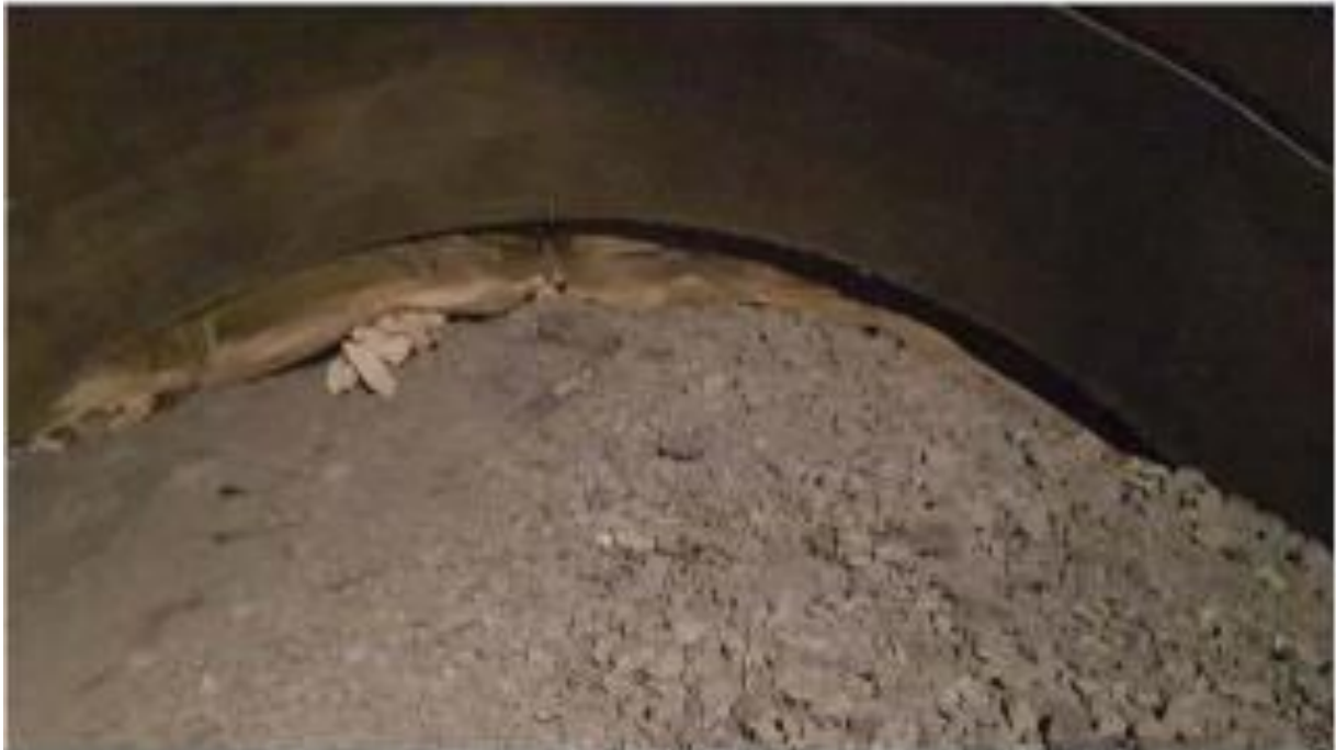
Figure II. 14 L'éboulement vue du côté sud.
