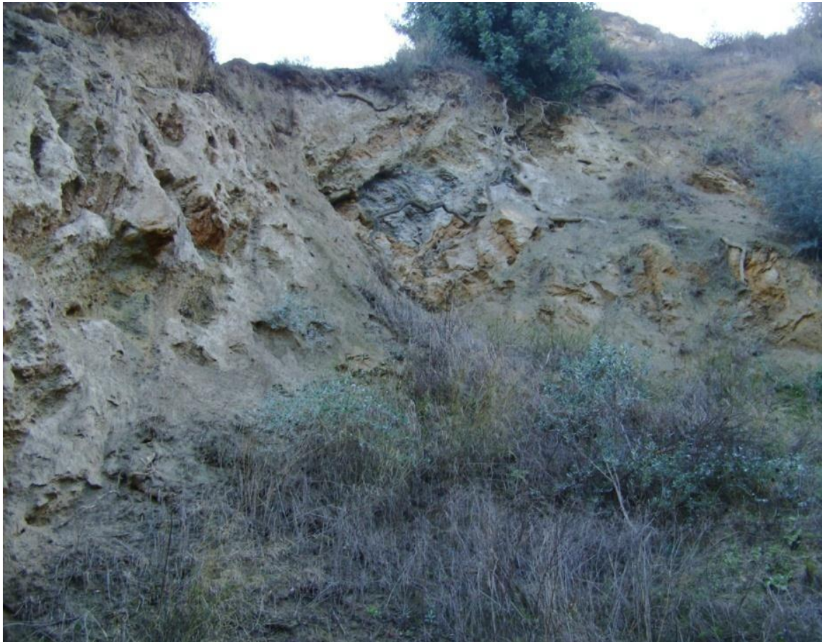
Figure II. 5 Flyschgrésos-argileux, crétacé, très fracturés dans la zone d'étude. [26]
