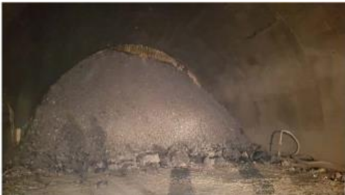
Figure II.15 L'éboulement vue du côté nord.
