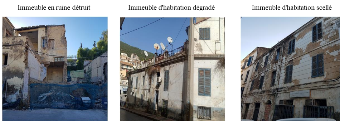
Figure 117 : L'État des immeubles d'habitations. Source : Auteur, 2023.
