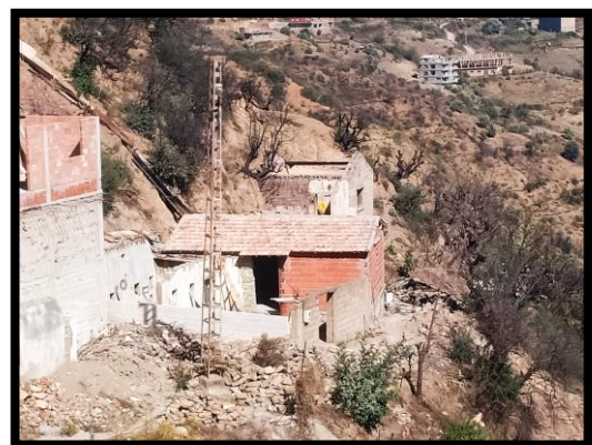
Figure 73 : une habitation en mauvais état inscrite dans un environnement inflammable Source : prise par l'auteur, 2023
