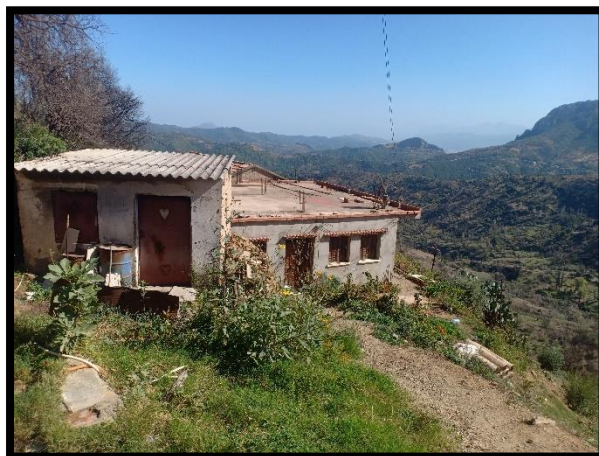
Figure 85 : habitation individuelle touchée par les incendies de forêt 2021 Source : (Prise par l'auteur, 2023)
