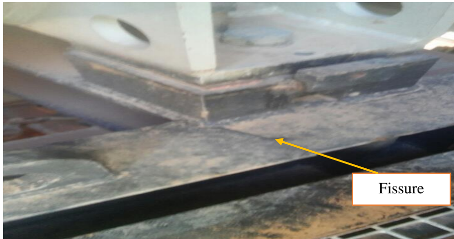
Figure I.8 fissure d'un châssis
