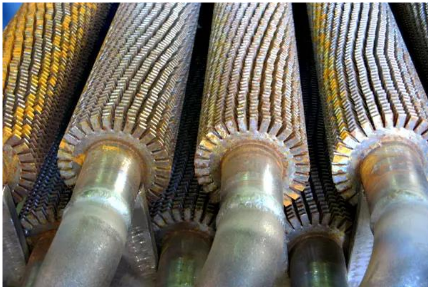
Figure IV.1: Economiseur vue de l'intérieur
