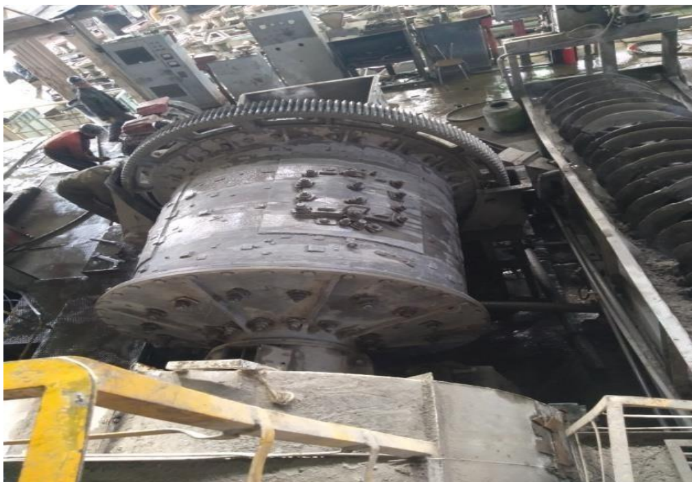
Figure II.14. Broyeur à boulets
