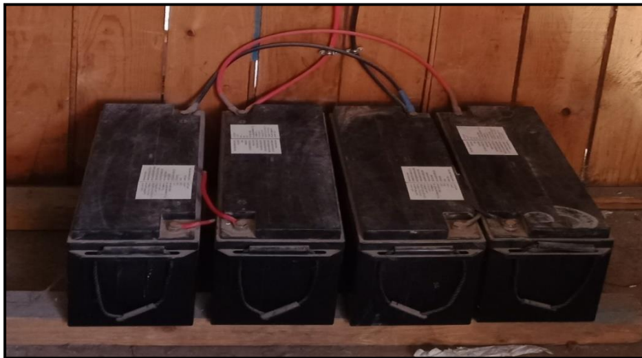
Figure IV.6 : Image des quatre batteries branchées en série et en parallèle.
