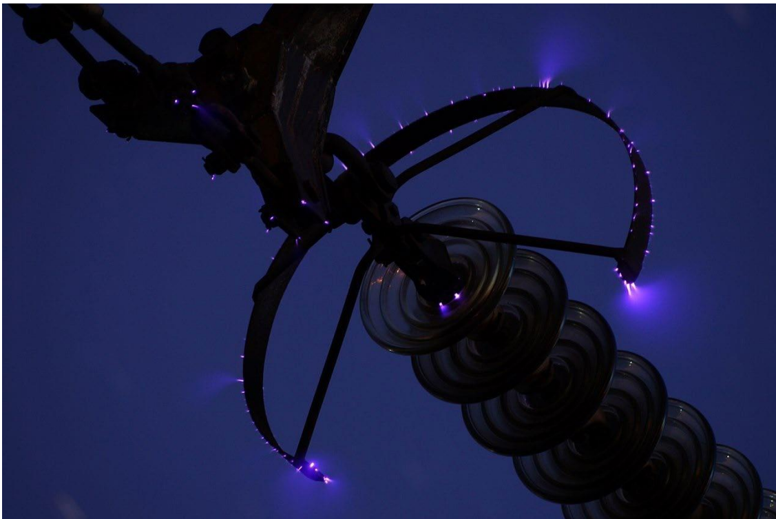
Fig.18 : Décharges corona à la surface d'un isolateur composite
