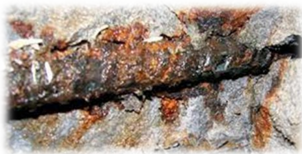
Figure 2 : Corrosion des armatures
