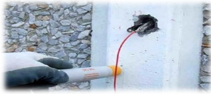
Figure 23 : Mesure du potentiel de corrosion.
