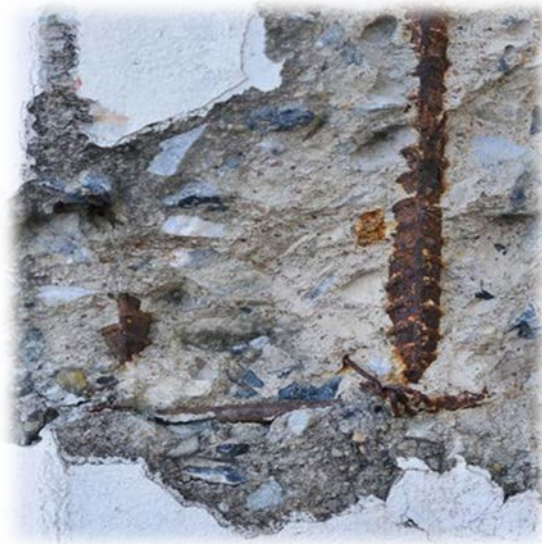
Figure 1 : Carbonatation du béton
