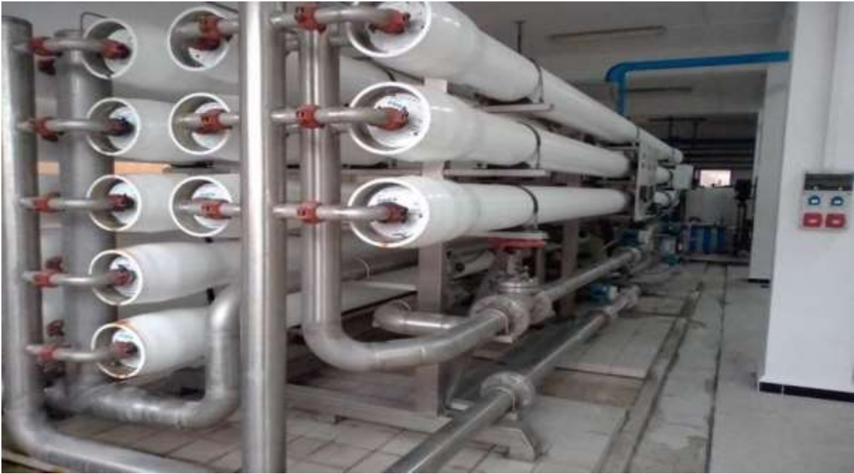
Figure I-6 : Une des lignes d'osmose inverse au niveau de Cevital [19].
