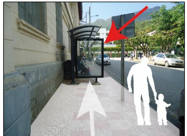
Figure 63 : Obstacle sur un trottoir au quartier de Lekhmis causé par un abri de bus.
