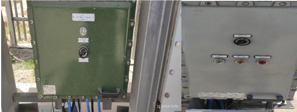
Figure I.17 : L'armoire de l'automate siemens. Figure I.18 : L'armoire de l'automate Schneider.
