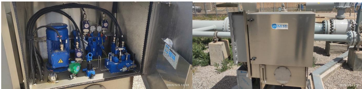
Figure I.9 : Vue d'une centrale hydraulique en intérieure et en extérieure.
