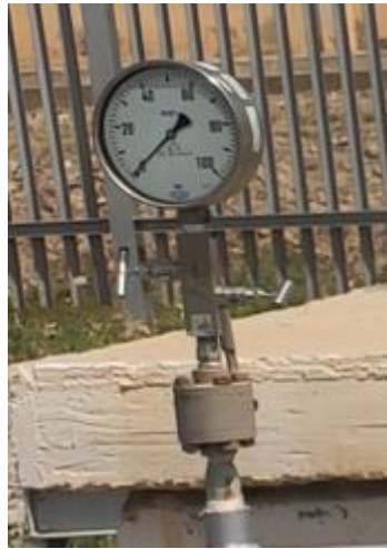
Figure I.8 : Manomètre de la station SBM.
