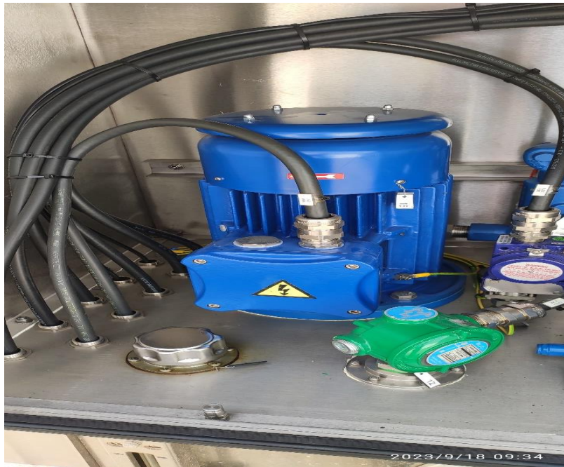
Figure I.15: Moteur de la centrale hydraulique.
