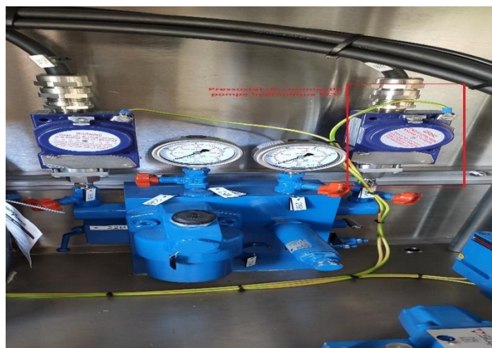
Figure I.13 : Pressostats de la centrale hydraulique.
