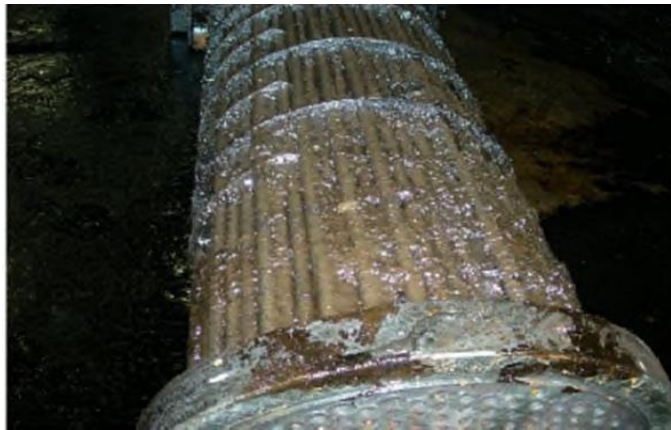
Figure I-9 : Exemple d'encrassement dans les échangeurs tubulaires
