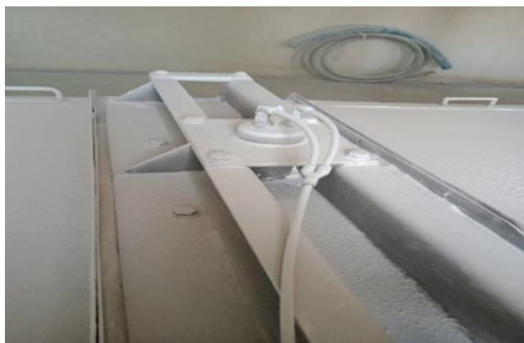
Figure II-2 : Injection de la graisse dans les paliers intermédiaire via une pompe à graisse Automatique
