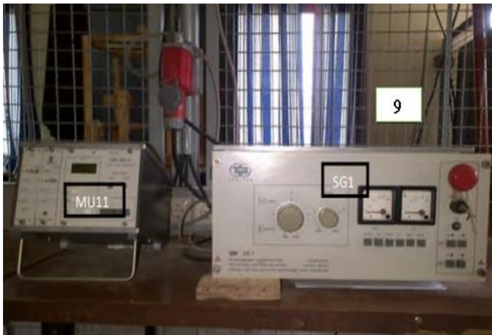
Figure II. 4: Equipements de l'installation haute tension utilisée
