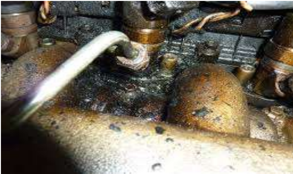
Figure 2.13 : Fuite des joints des injecteurs
