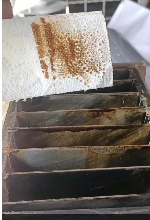
Figure IV.5 : dépôt de goudron sur les électrodes.
