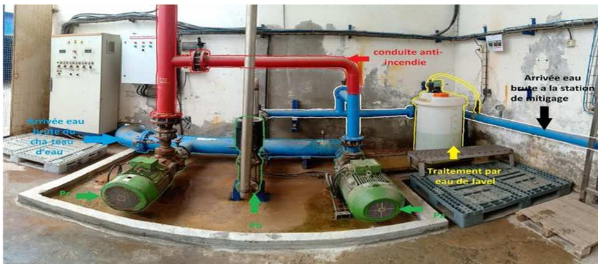
Figure (II.1) Photo de l'arrivée de l'eau brute à la station.
