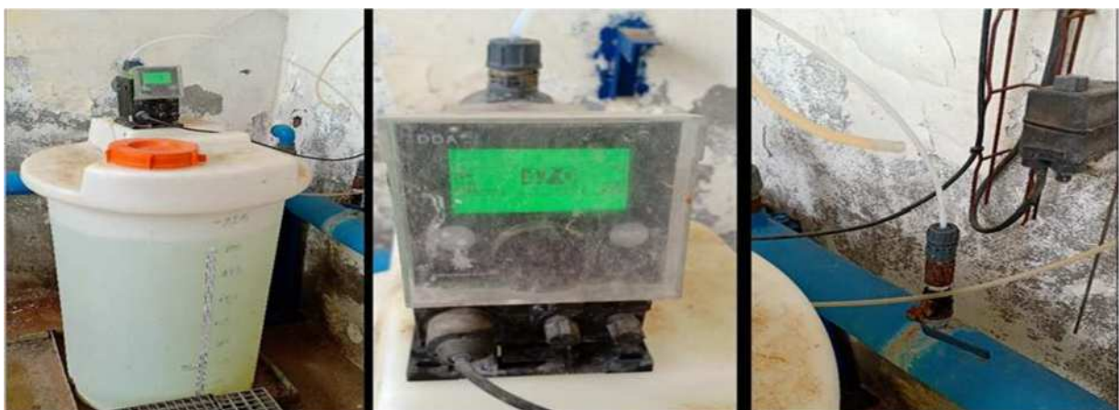
Figure (II.2) Photo du mécanisme de traitement par eau de javel.
