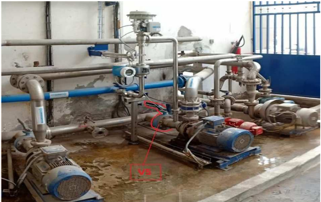
Figure (II.7) : Photo de la vanne manuelle V5.
