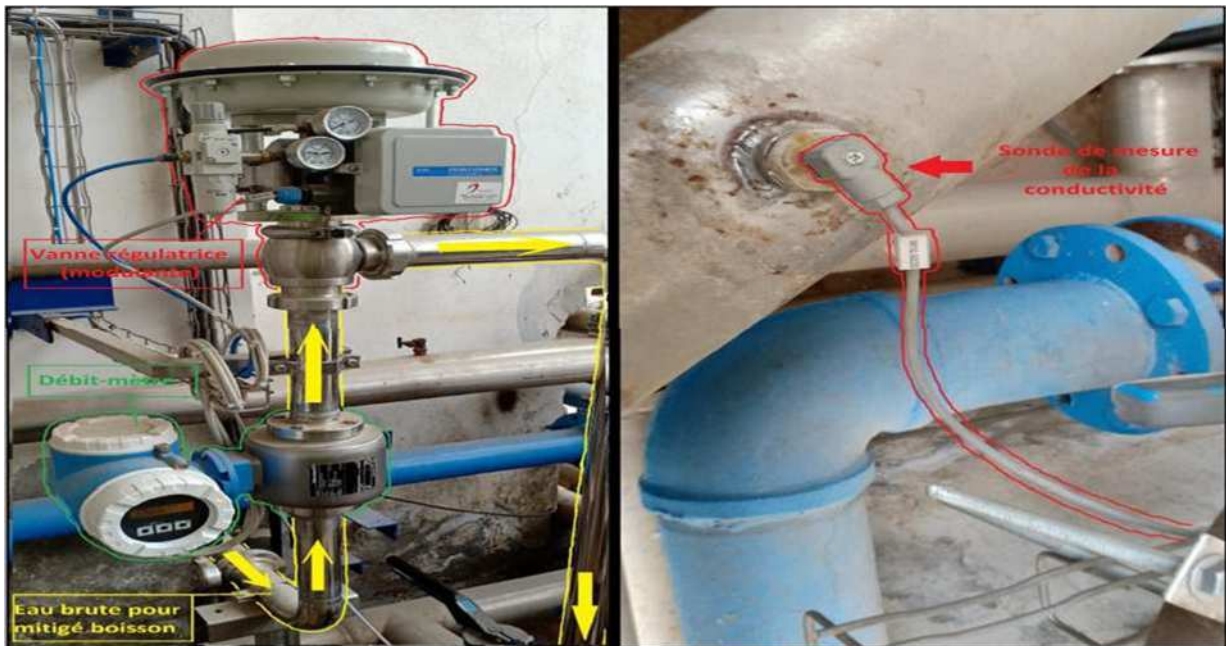
Figure (II.4) Photo de la sonde de conductivité et la vanne régulatrice
