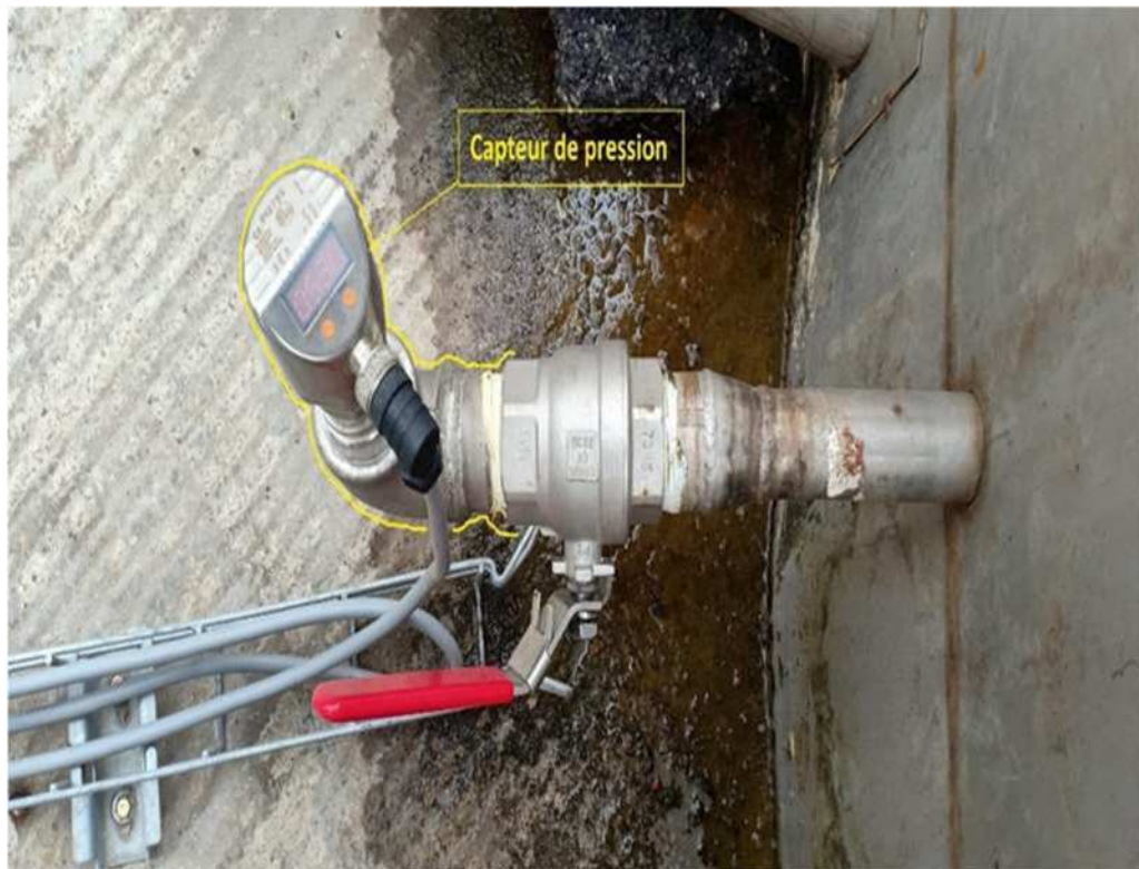
Figure (II.8) : Photo du capteur de pression du bac mitigé boisson.
