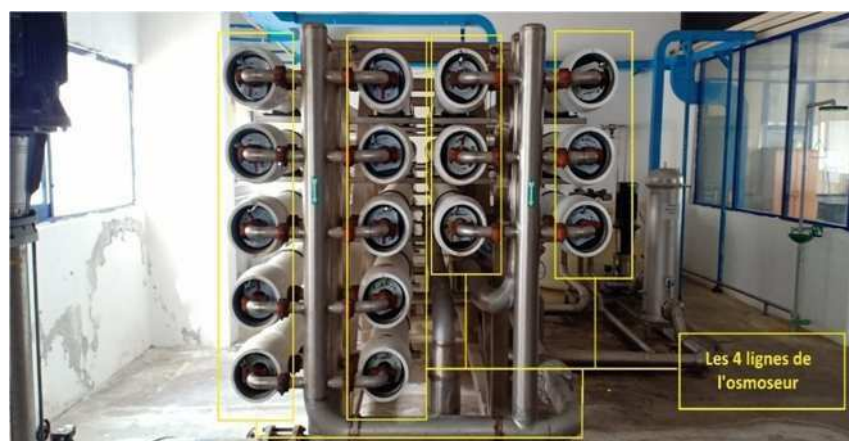
Figure (I.6) : Photos des 4 lignes de l'osmoseur inverse
