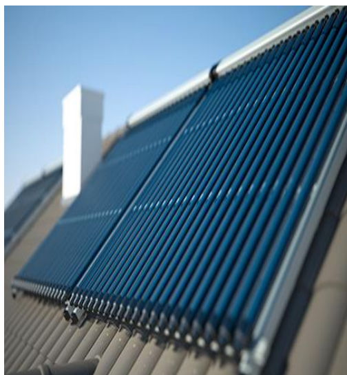
Figure I.2 : Panneau solaire Thermique.[9]
