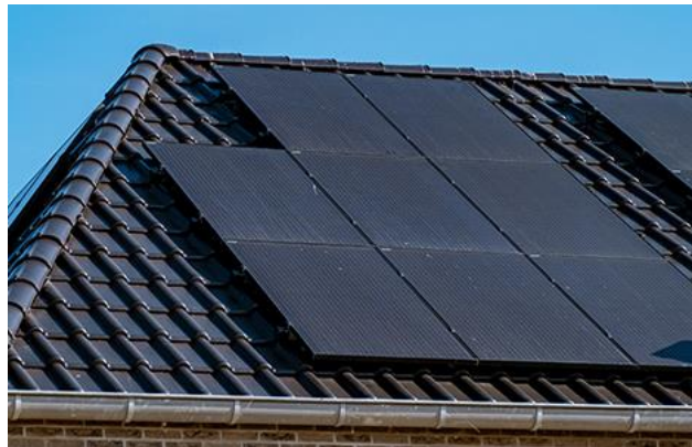
Figure I.3 : Panneaux solaires Hybrides.[9]
