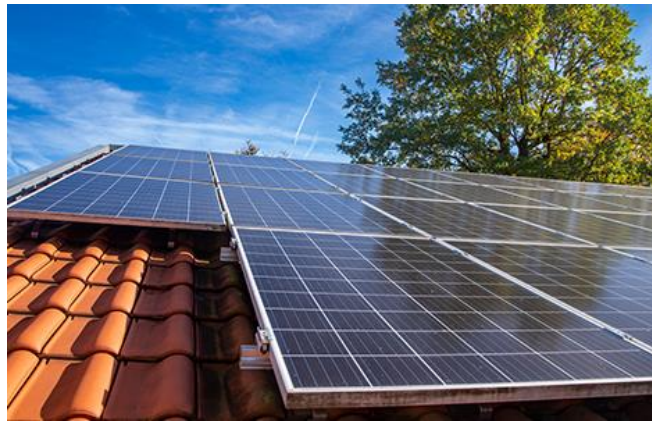
Figure I.4 : Panneau solaire photovoltaïque.[4]
