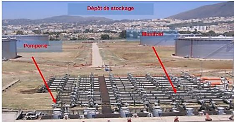
Figure I.5 : Un manifold arrivée/départ et une pomperie de chargement [8]
