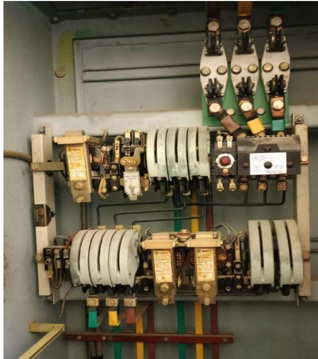
FigureIII.17: Armoire électrique à l'intérieur.
