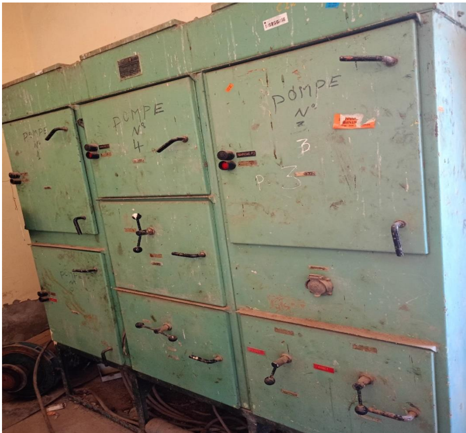
Figure III.16: Armoire électrique de l'extérieur.
