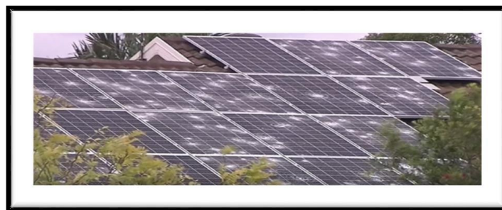
Figure II-3 : Défaut de bulles d'air [30].
