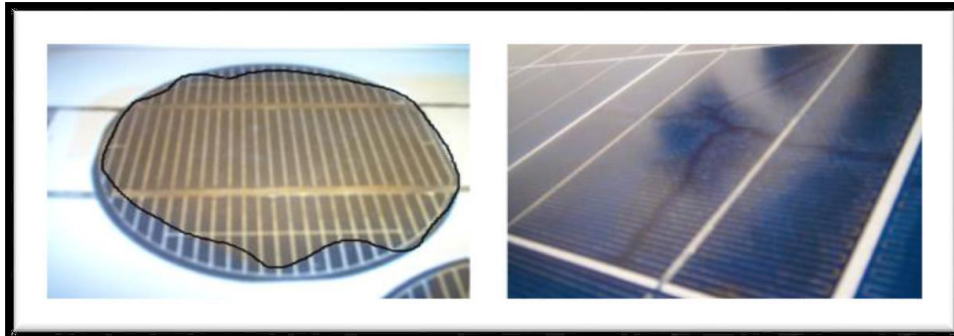
Figure II.2 : Modules photovoltaïques avec des cellules décolorées [28].
