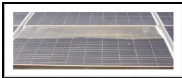
Figure II.5 : Défaut de délaminage [32].
