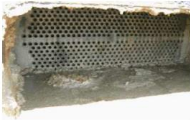
Figure1-7: Dépôt des limes bactériens, hydrocarbures et oxydes métalliques
