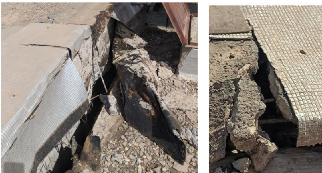
Figure 15- Eclatement des extrémités de l'acrotère entre les deux blocs.
