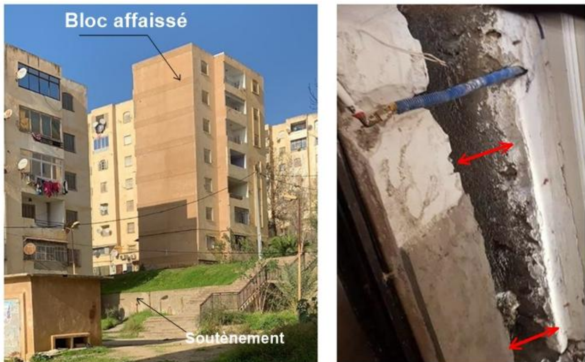
Figure 13- Vue du bâtiment affecté et ouverture du joint de dilatation
