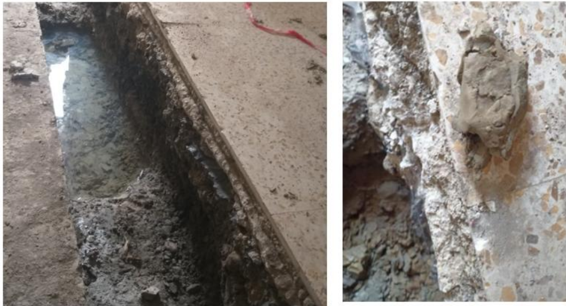
Figure 16- Argile grisâtre et humidité (stagnation d'eau au niveau des fondations)
