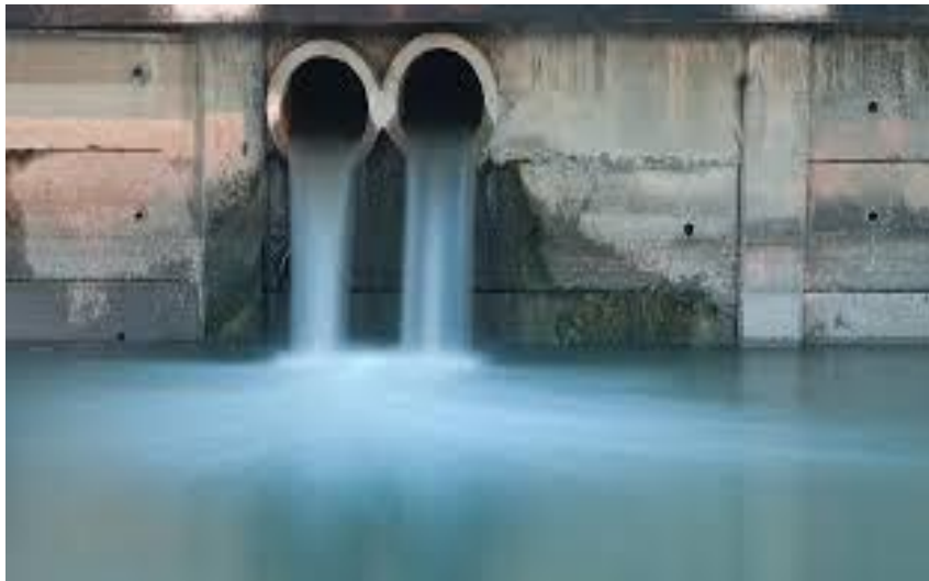
Figure 1 : Eaux usée (Photographie 1)
