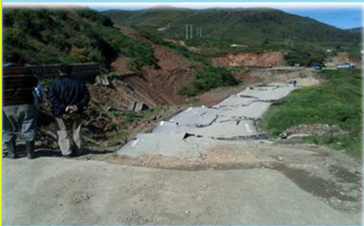
Figure 6: Glissement de terrain sur la RN 24, au niveau de village touristique de Tghremt, Toudja
