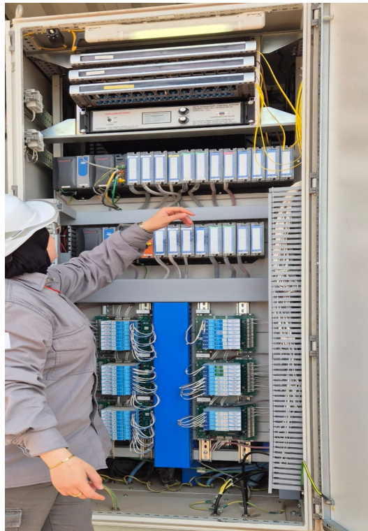
FIGURE 1.7 – Automate programmable industriel (PLC) installé sur site, à proximité d'un puits
