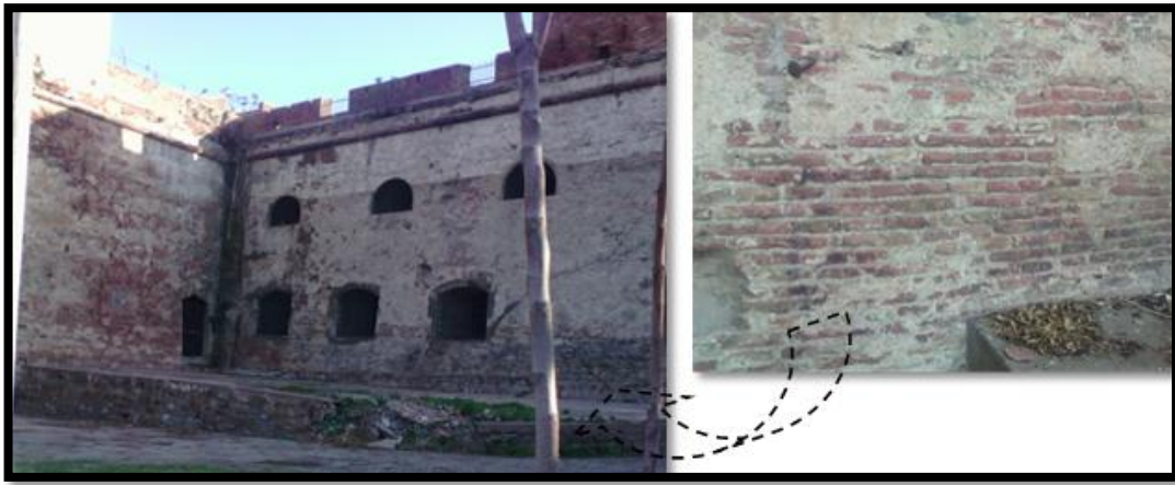
Figure 3.38: Appareillage français sur la façade ouest
