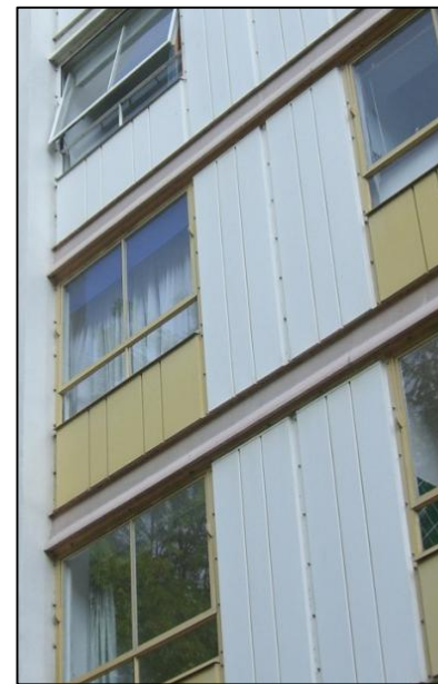
Figure 48 : condensation sur les vitrages. (Source : F. SGORBINI, 2013, p 02.)
