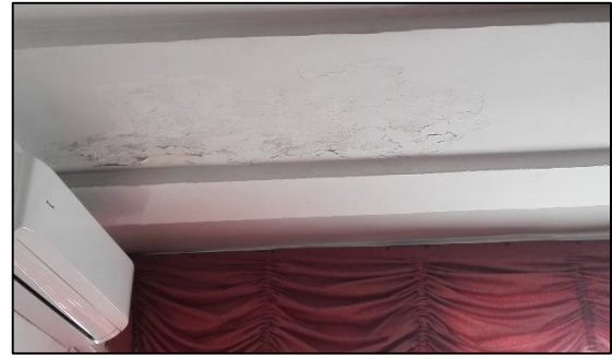
Figure 152 : L'humidité au niveau du plafond. (Source : auteurs, 2016.)
