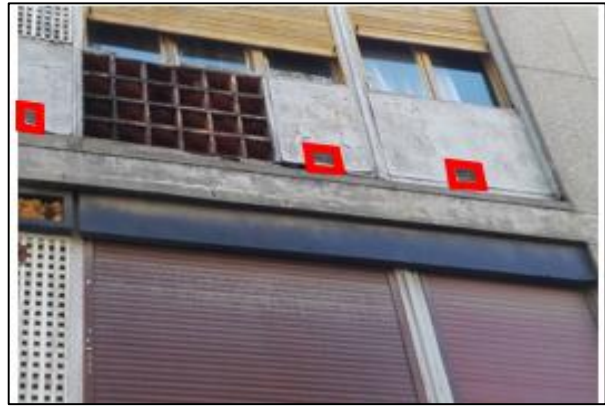
Figure 133 : Grilles d'aérations. (Source : auteurs, 2016.)
