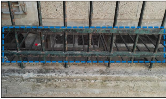
Figure 151: Grille d'aération sur la façade nord-ouest. (Source : auteurs, 2016.)
