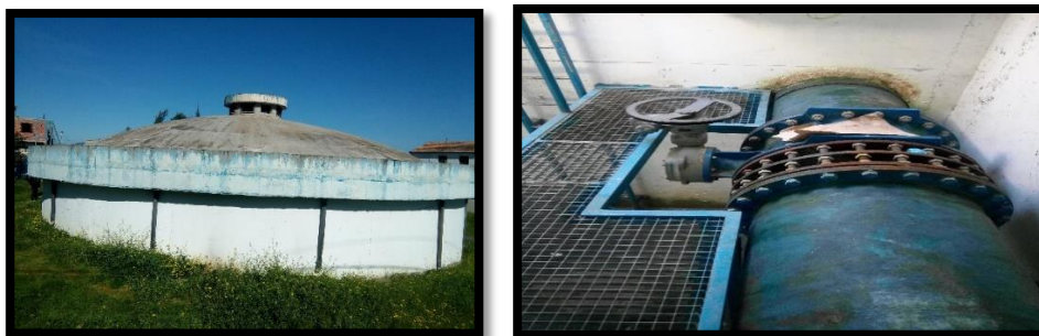
Figure (III.1) : Réservoir de Tazazrait et la chambre de vanne
