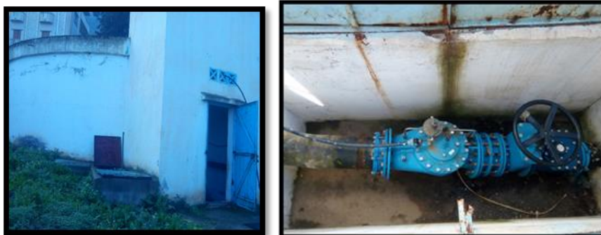
Figure (III.2) : Vue extérieure du réservoir de la SR1 et la chambre de vanne
