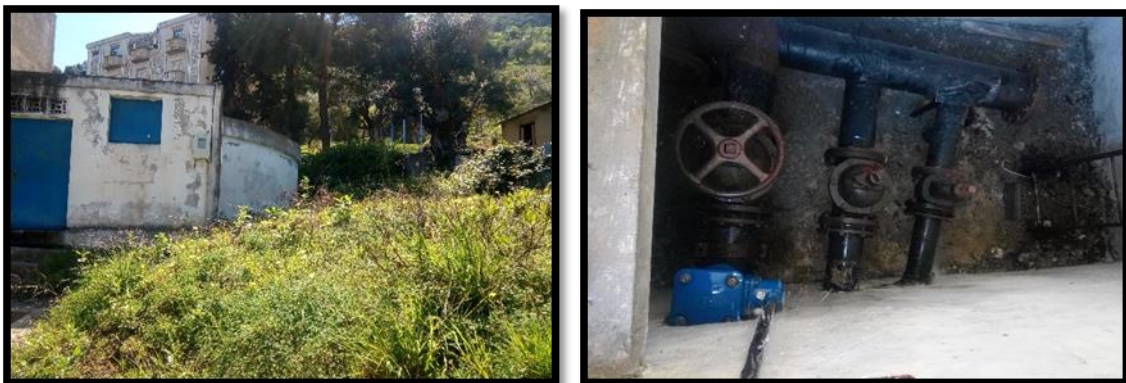
Figure (III.4) : Vue extérieure du réservoir d'Ikhriben et la chambre de vanne
