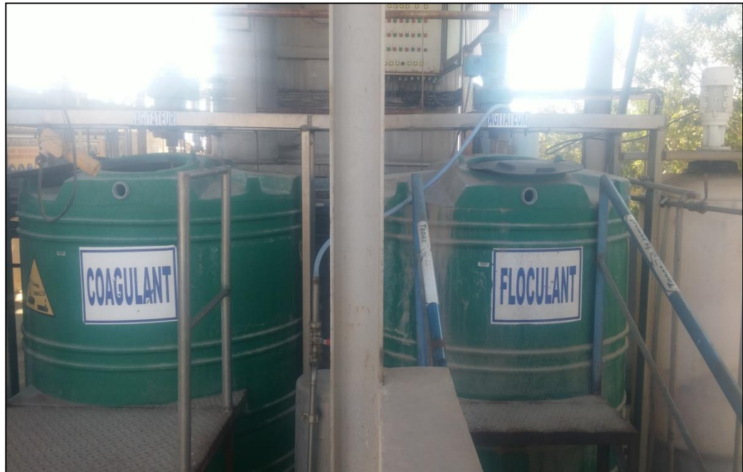
Figure N° 6 : Photo d'un système automatique de contrôle de la coagulation et la floculation (Cliché Achiou, 2017).
