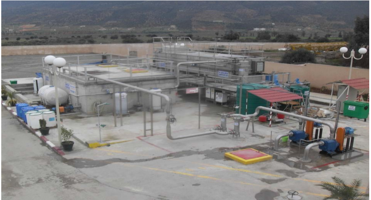
Figure N° 3 : Station d'épuration de Danone Djurdjura Algérie (Guide de l'opérateur de la STEP DDA, 2009).
