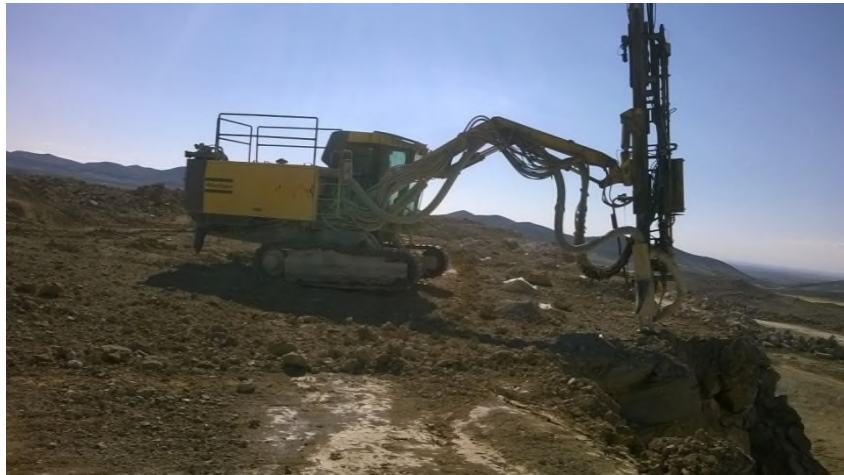
Figure II.4 Sondeuse ATLAS COOP (source : lieu de stage Chouf Amar).
