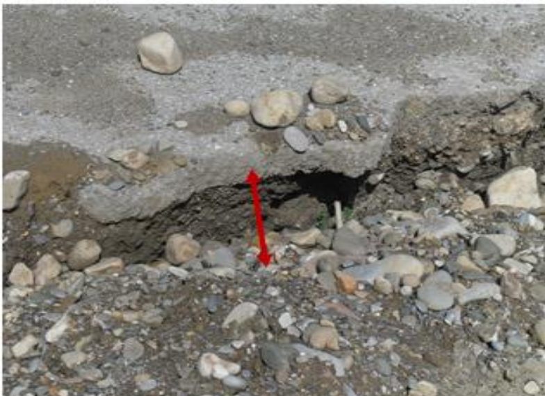
Figure II-2 : Escarpement avec un rejet d 50 cm au niveau de la chaussée
