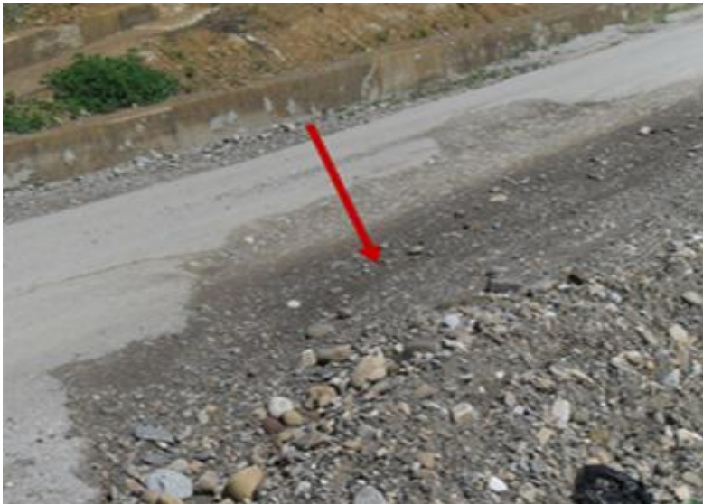
Figure II-1 : Déformation et affaissement de la chaussée
