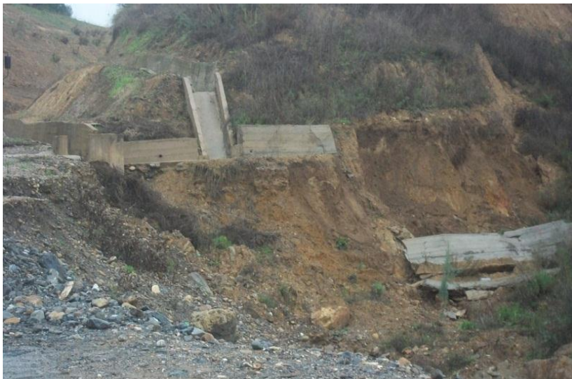
Figure II-4 : Rupture des ouvrages de drainage
