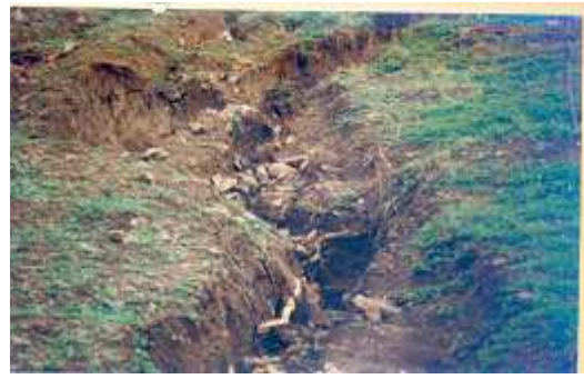
Photo n° 2 : Erosion par ravinement (El-Kseur, 2003)
