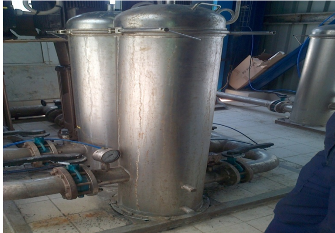
Figure III.2 : Face externe des filtres à cartouches utilisées au niveau de Cevital.
