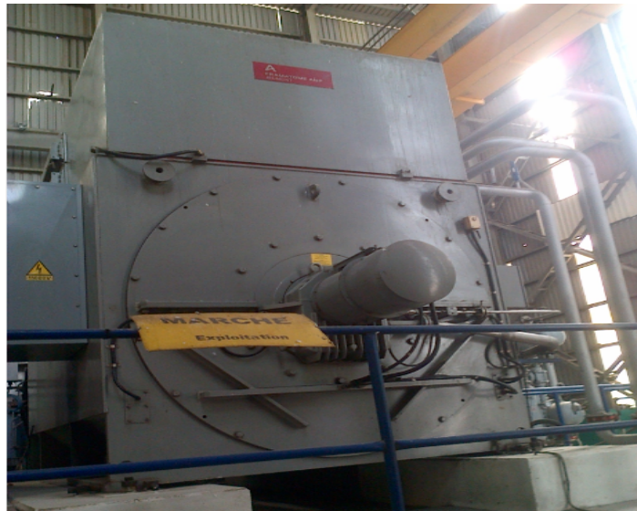
Figure III.9 : La face externe d'une turbine à vapeur utilisée au Cevital.
