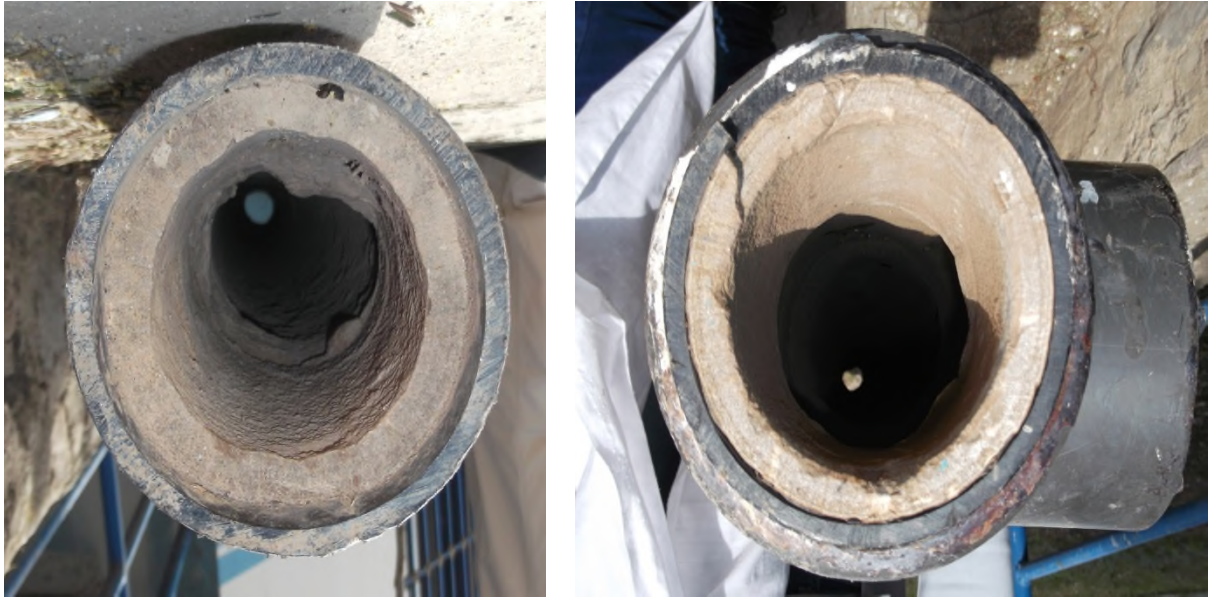
Figure IV.4 : Dépôt de calcaire formé dans une conduite.
