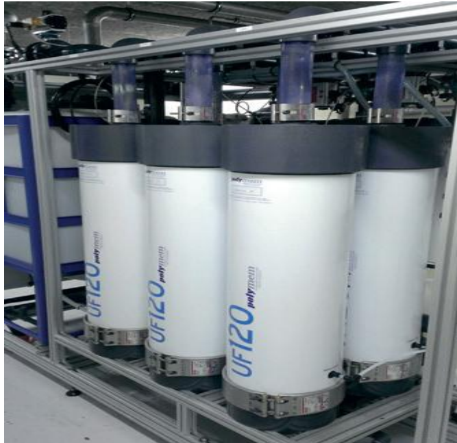
Figure IV.12 : station de filtrage par membrane
