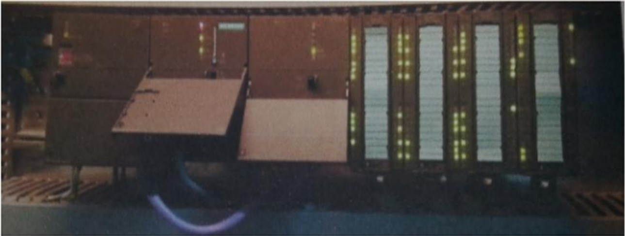
Figure IV.3 : Vue générale d'API Siemens S7-300 utilisé dans l'usine Cevital-Bejaia
