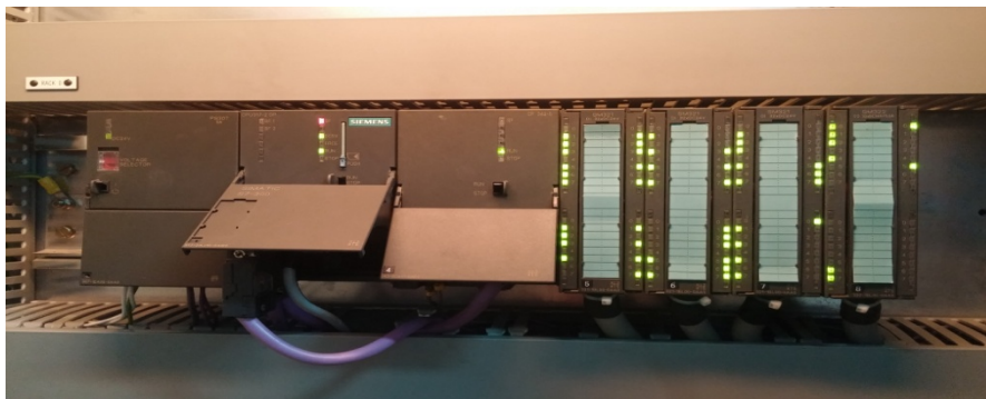
Figure II.11. Vue générale d'API siemens S7-300 utilisé
