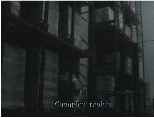
FIGURE 1.6 – La chambre froide
