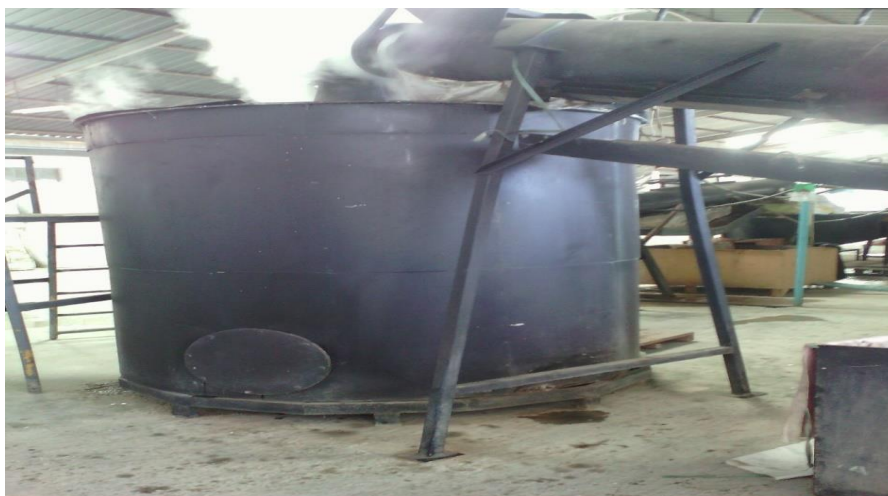
Figure 21 : Cuve de lavage.
