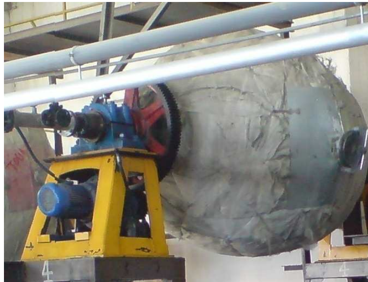
Figure 22. Tank où se déroule le séchage.
