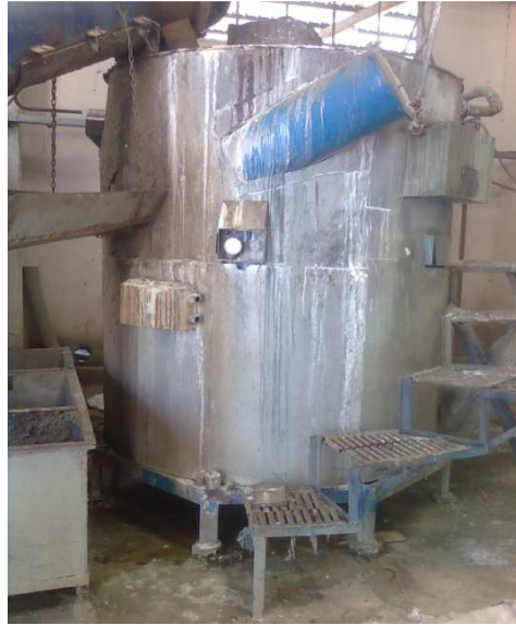
Figure 20. Cuve de lavage.
