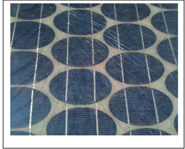
Fig. III.6 : Rupture du verre du module
