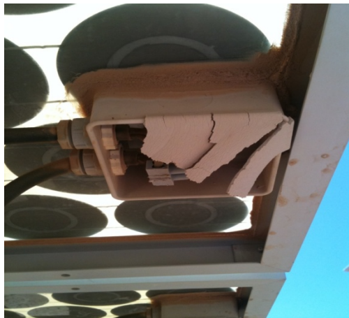
Fig. III.2 : Effet de la température sur la boite à jonction
