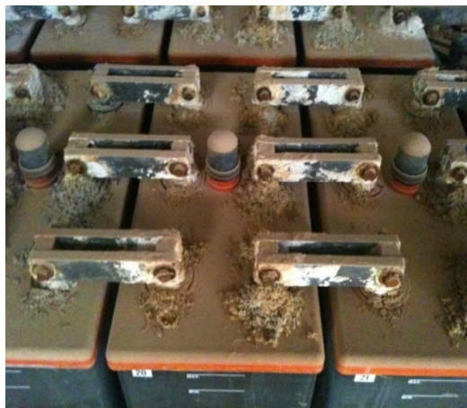
Fig.III.3: batterie sans entretien.
